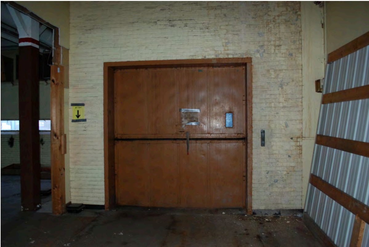
15 Elevator door typical.JPG
